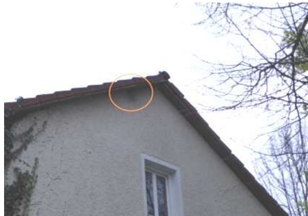
Abbildung 7: Verfärbungen an der Südseite des Bürgertreffs die auf eine Nutzung durch Fledermäuse hindeuten
